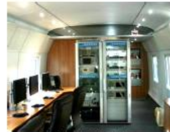
通信检测系统
